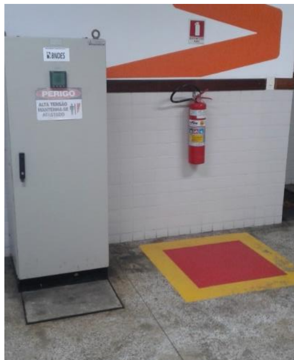
Figura 4 – Extintor ABC sinalizado em área interna da instituição
